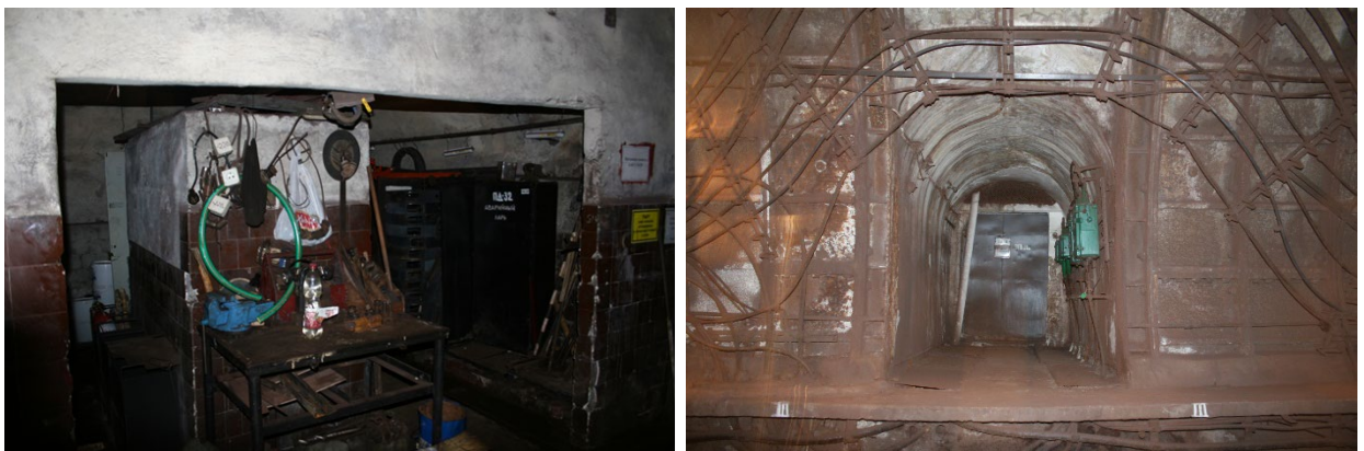
Рисунок 2.10 – Техническое помещение на въезде к ст. «Курская» по второму пути (слева) и понизительная подстанция (справа)
